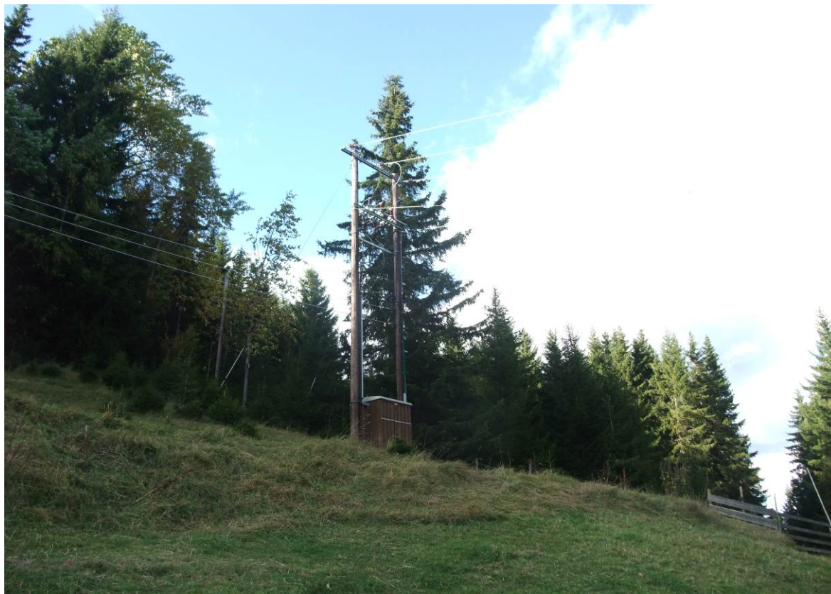
Bilde 6.1 22 kV kraftlinje med endemast på Hovdelia
