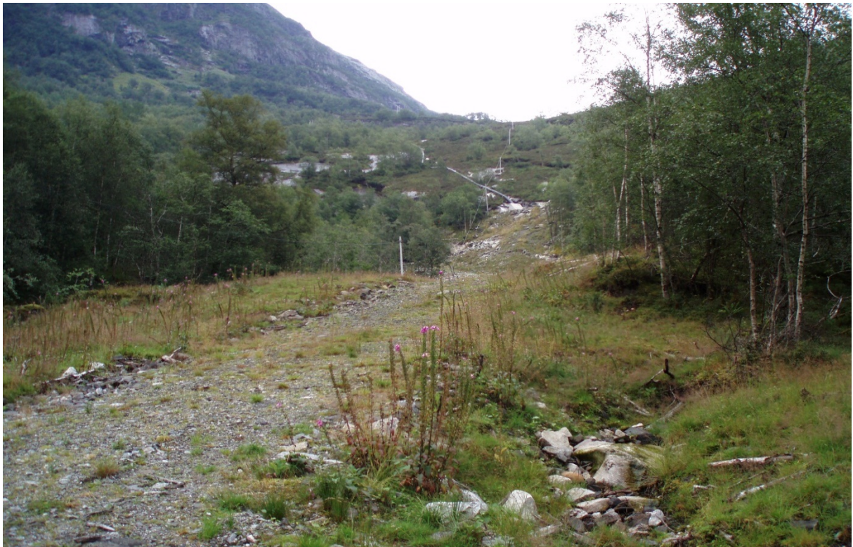
Eksempel på rørtrase i dagen og delvis nedgravd ved Gjerde Kraftverk
