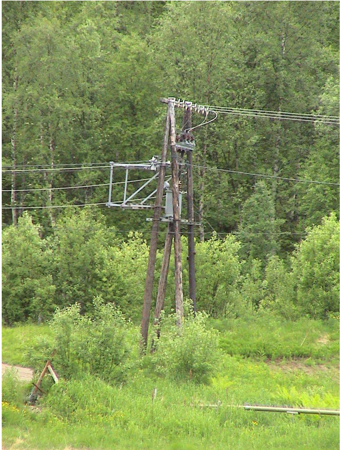
Bilde 6.1 22 kV linje ved stasjon
