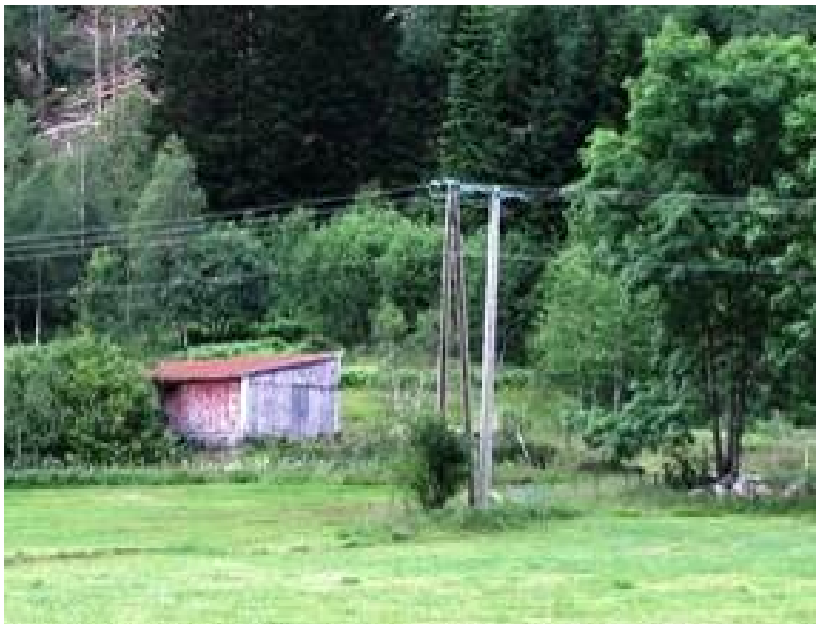
Bilde 6.1 Eksisterende 22 kV linje ved mulig tilkoblingspunkt
