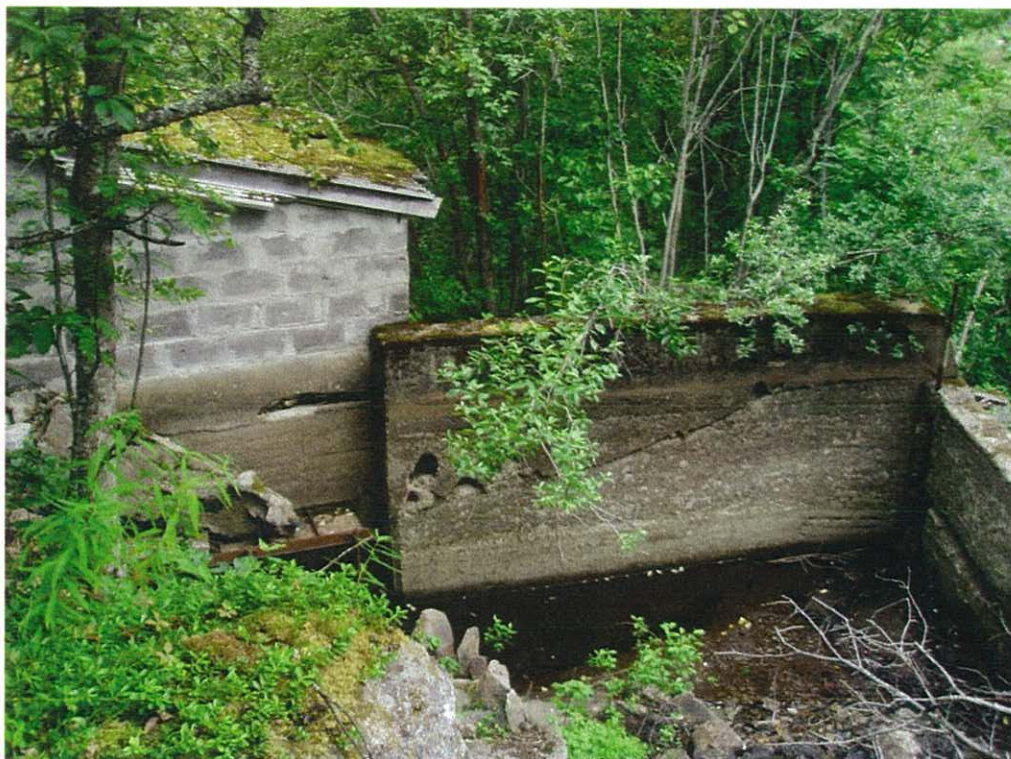
Nedlagt vanninntak Foto: Bente Sved Skottvoll
