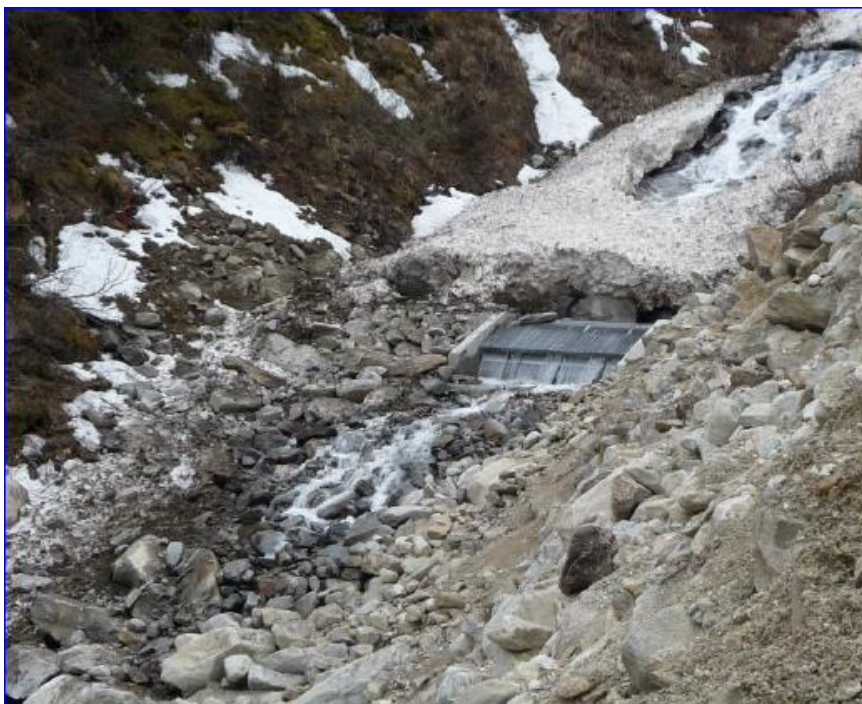
Figur 2.2.4.2. Coandainntak med rasvern påmontert. Eksempel frå Alpane.
