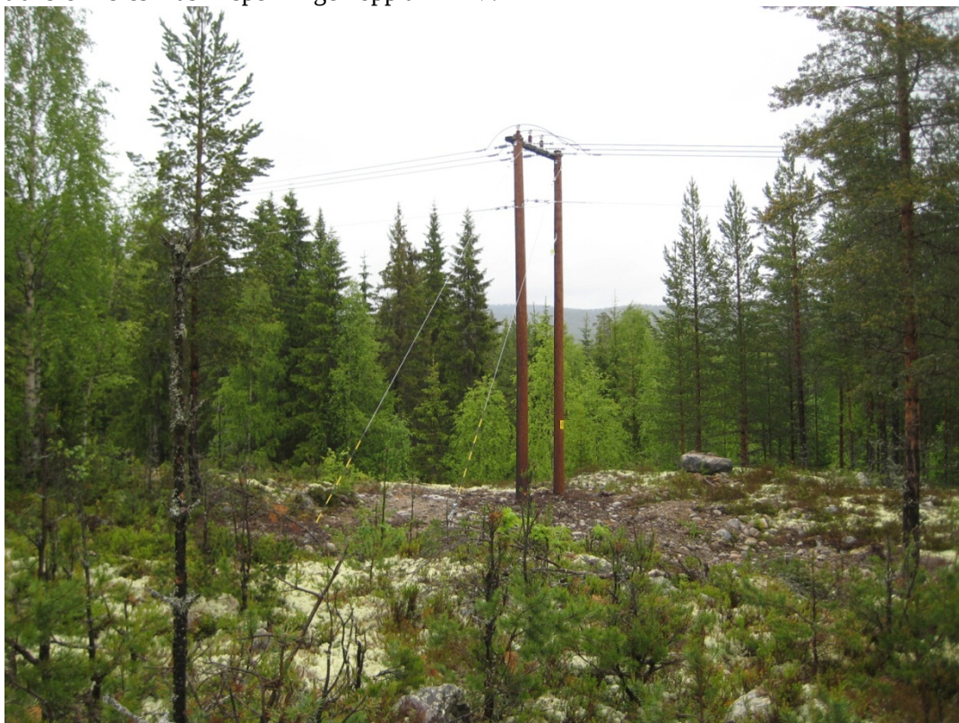
Figur 11. Tilknytningspunkt til Eidsiva Nett's 22 kV ledning
