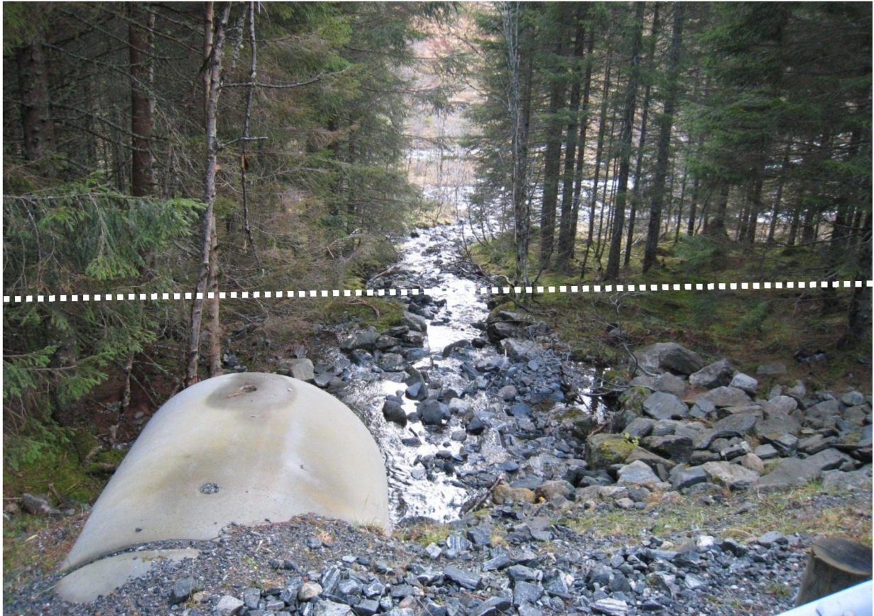
Figur 14 Rørtraseen der den krysser Tverrelva som får samløp med Osdalselva på kote ca. 315. Vannretningen er fra høyre mot venstre.
