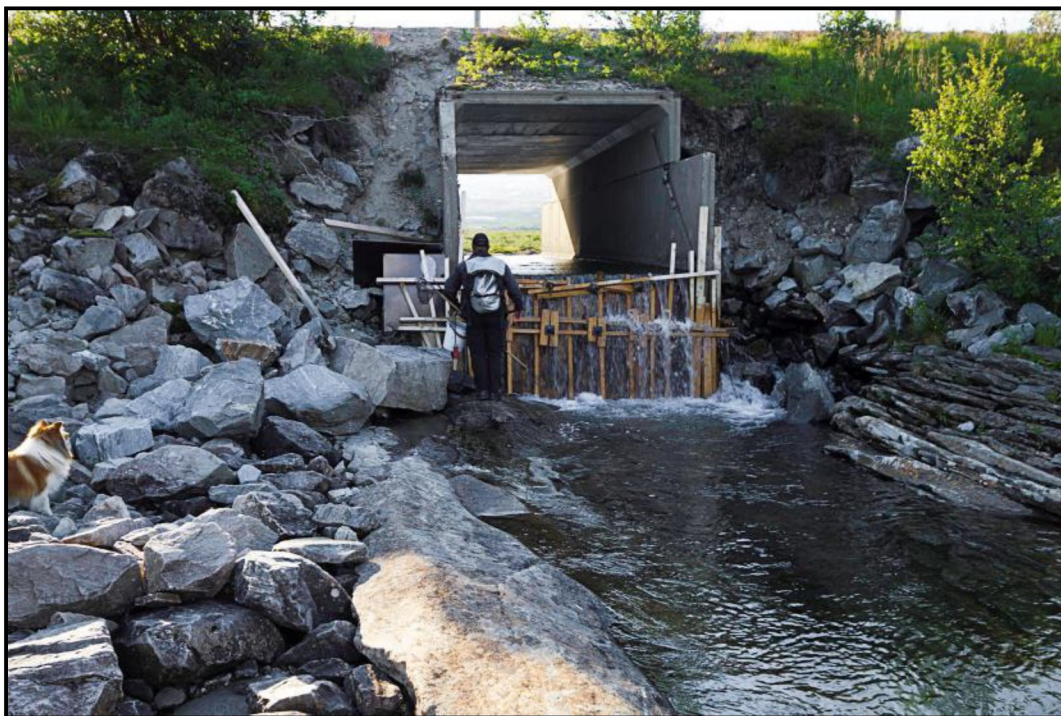
Figur 3-6. Ca 130 m oppstrøms det planlagte inntaket for kraftverket krysser elva riksveien. Kulverten under veien er et godt eksempel på hvordan du kan bygge et vandringshinder for fisk. Foto 16.08.2012 av Finn Gravem, Sweco.
