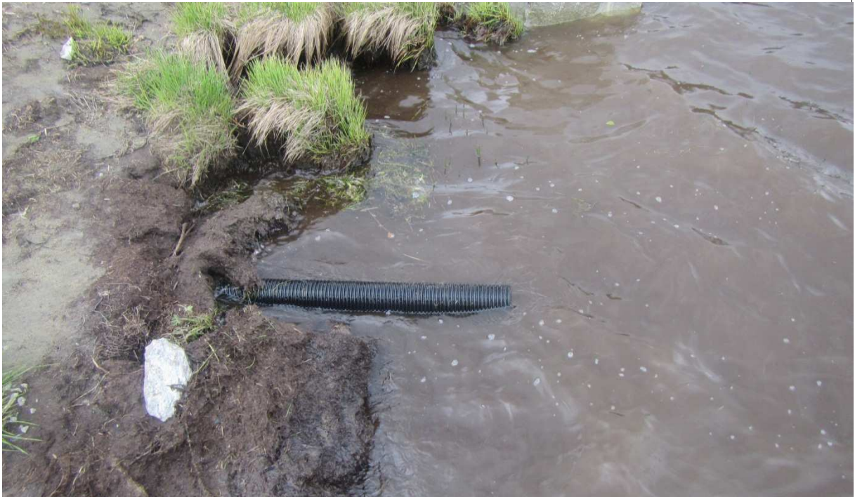
Figur 4-4 Drensrør med utløp ca. kote 720,10 i Søre Vindin.
