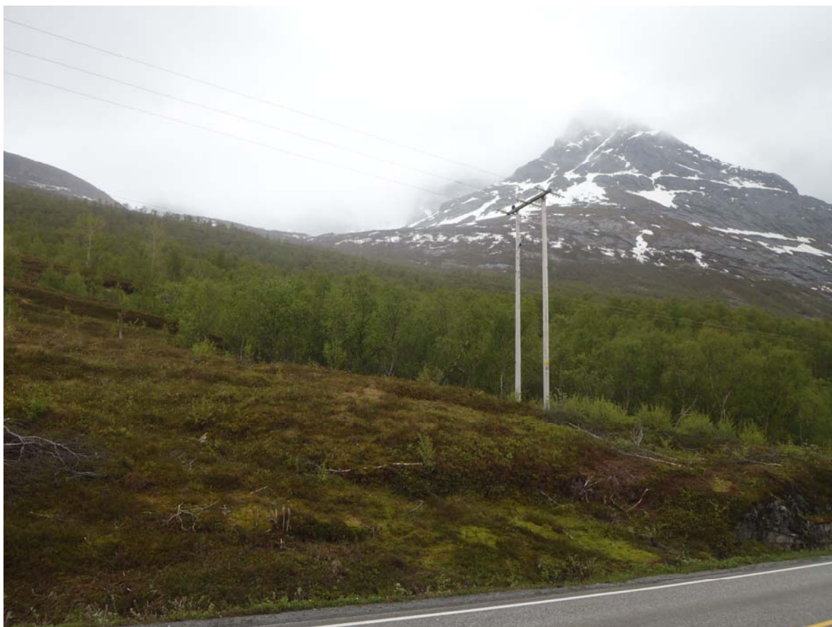
Figur 22 Eksisterende kraftlinje 22 kV parallelt med FV 17.
