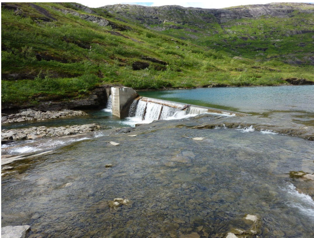
Figur 8. Dammen er preget av elde og slitasje.
