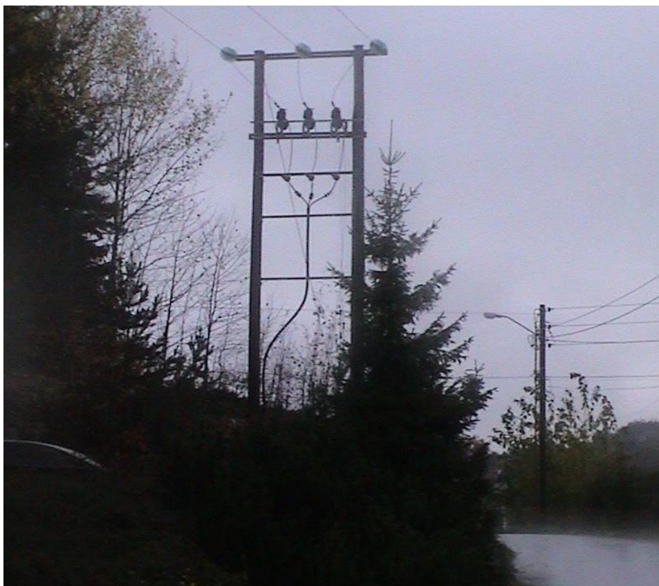
Bilde 4.1 Eksisterende 22 kV nettstasjon
