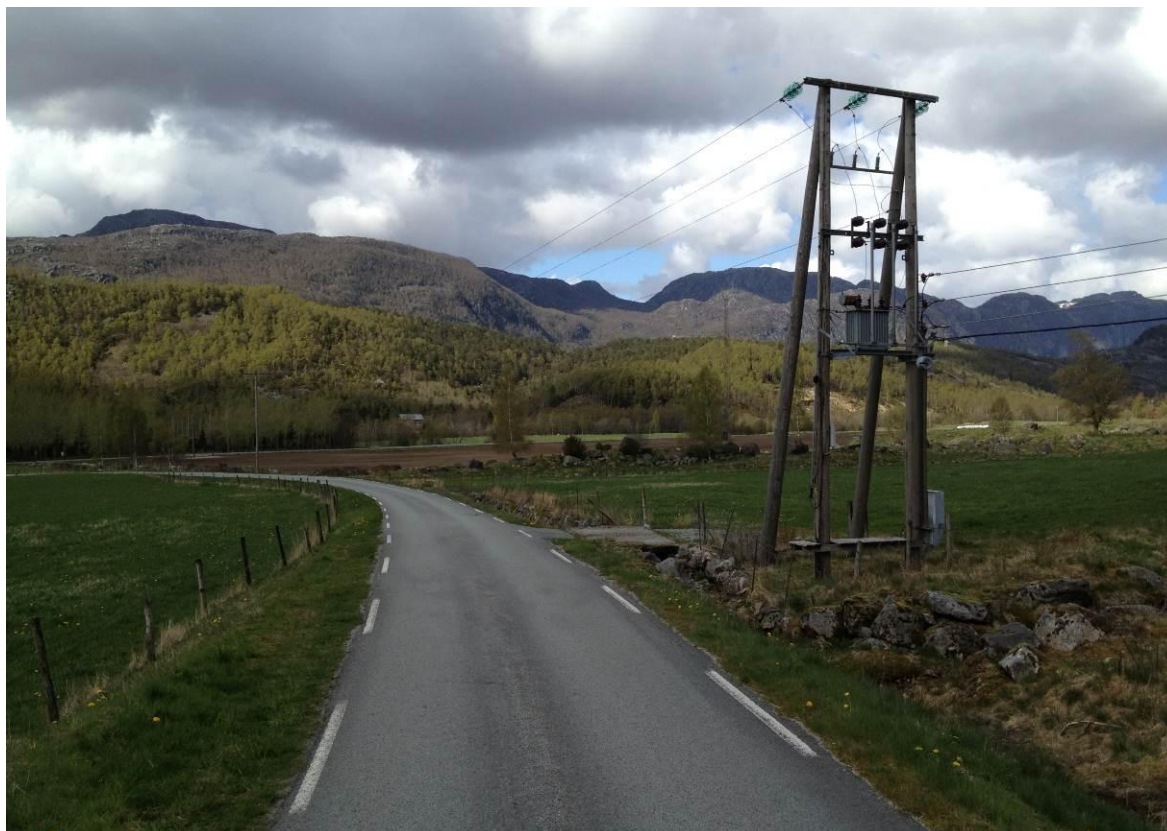
Bilde 6.1 Endemast på 22 kV kraftlinje nede ved Ullestad
