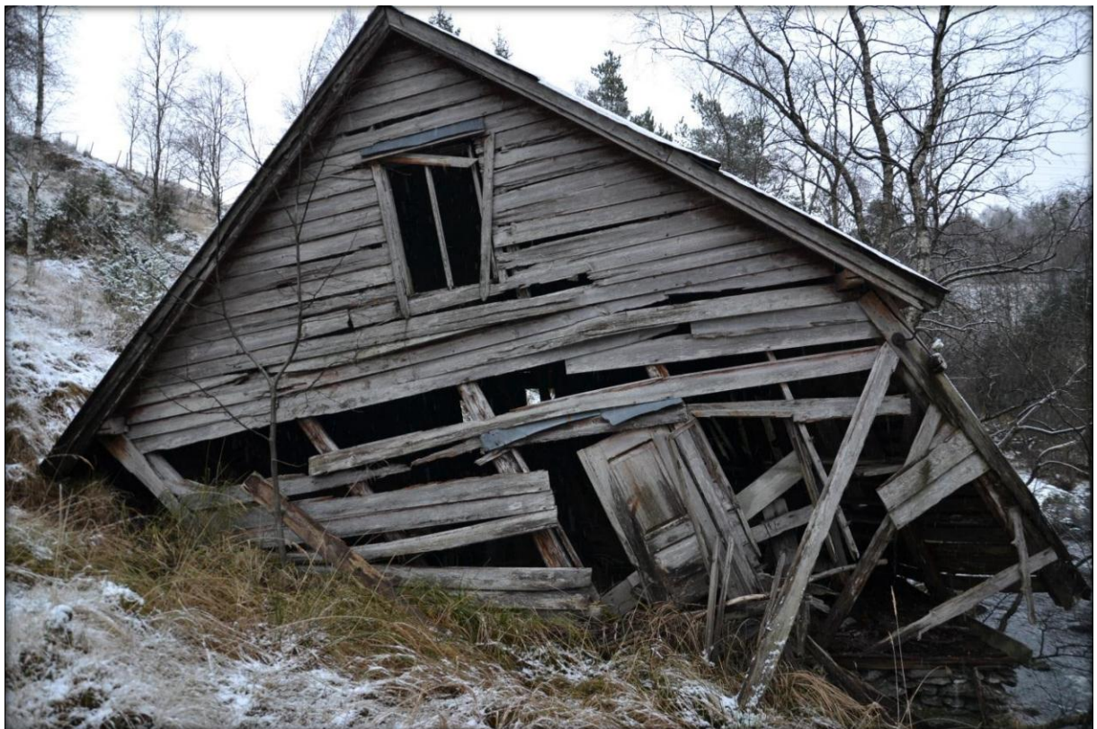
Bilete 30. Som ein kan sjå av bilete, er bygningen (ref. bilete 29) i svært dårleg forfatning og det er fare for at grunnmuren raser ut ved flaum eller høg vassføring. Ein vil her saman med kommunen vurdere kva som skal gjerast. Bygget vert ikkje råka av utbygginga, ein skal leggja boreholet nokre meter nord for bygget.
