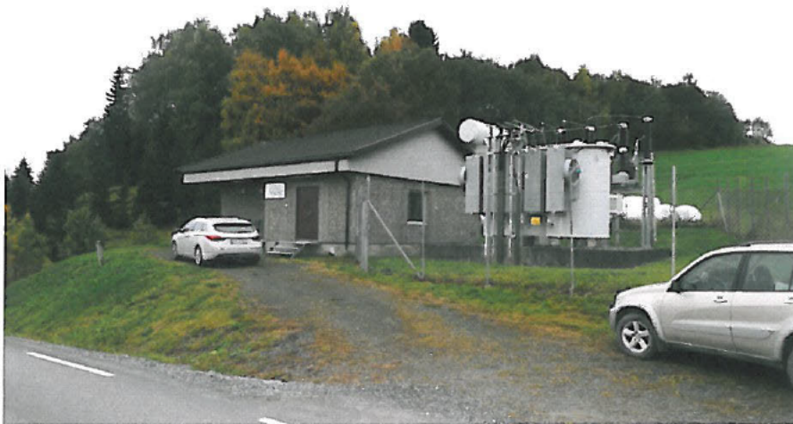
Fig. 16 Skogn trafostasjon. Dagens anlegg
