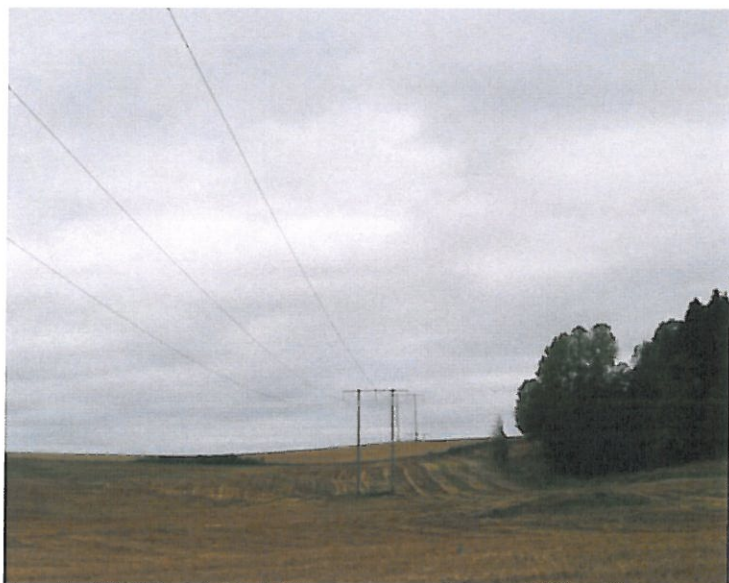
Foto: Eks. 66 kV ledning nord om Skogn
