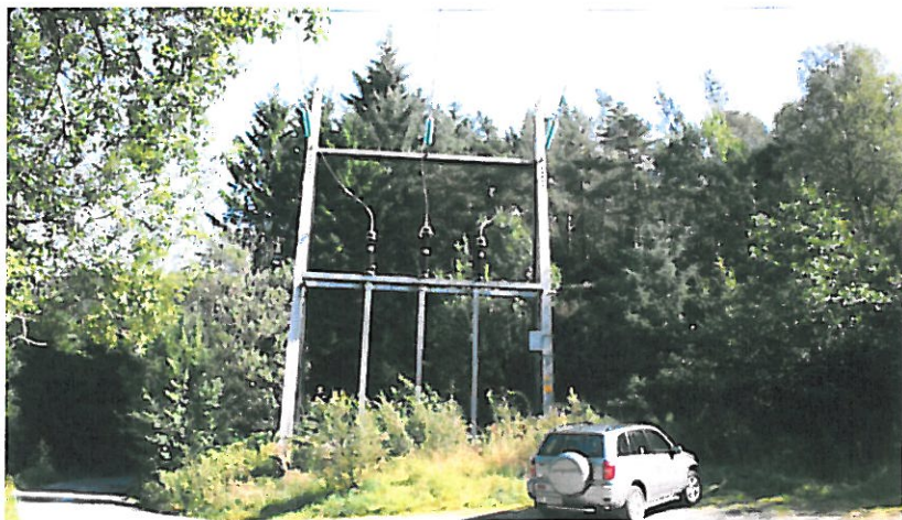
Fig. 24 Foto av typisk 132 kV kabelendemast. Overgang mellom 132 kV jordkabel og 132 kV luftledning og 132 kV sjøkabel og 132 kV luftledning.
