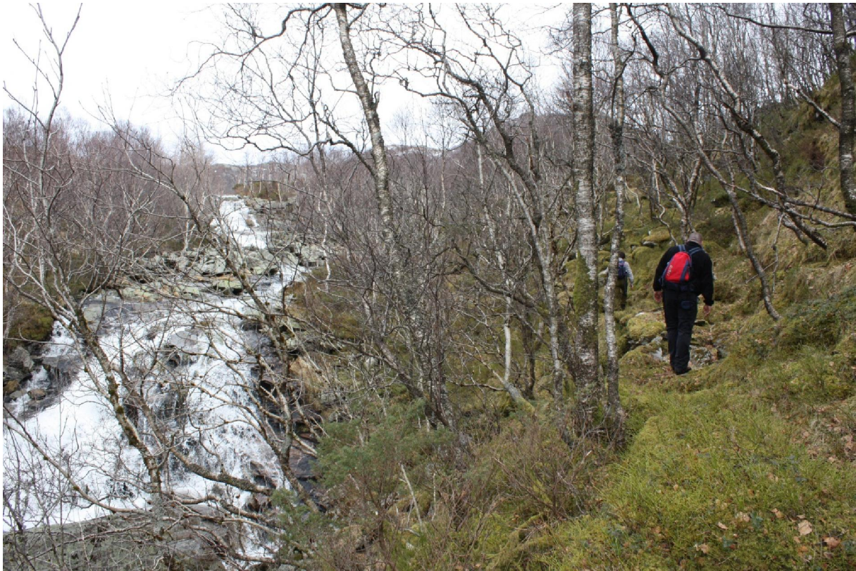
Bilde 12: Øvre del av rørgatetrase til høyre i bildet
