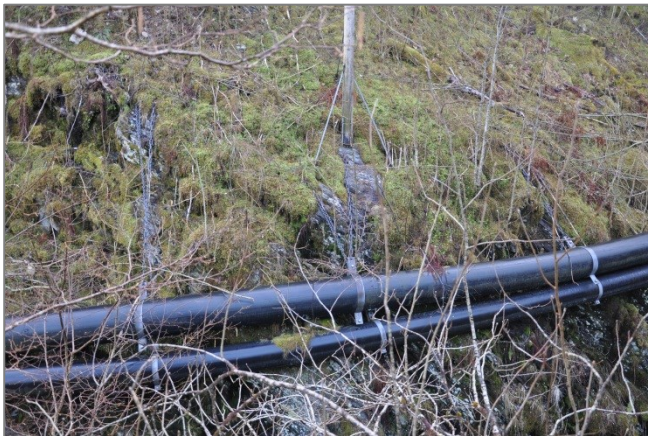
Bilde 28: Ledninger klamret på fjell
