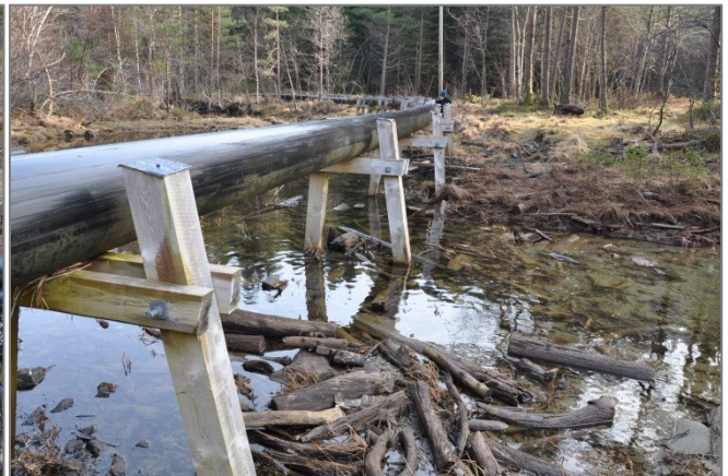
Bilde 29: Ledning fra dam 1
