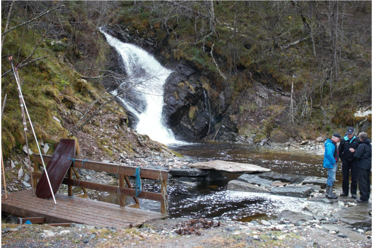
Bilde 3 – Inntak for overføringsledningen fra Daudfosselva. Selve røret starter under trebroen i forgrunnen.
