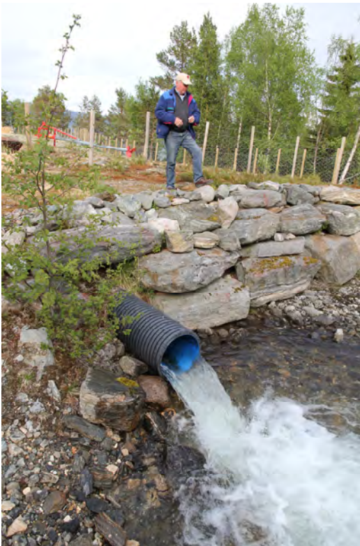
Nærbilde av Ø350-rør som overfører vann fra Daufosselva når det renner ut i inntaksdammen til Kvitefella kraftverk
