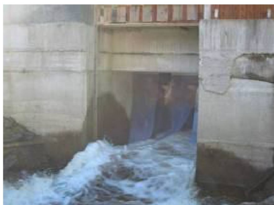
Bilde 16: Avløpskanal Nørståe I. Foto: Elvekraft
