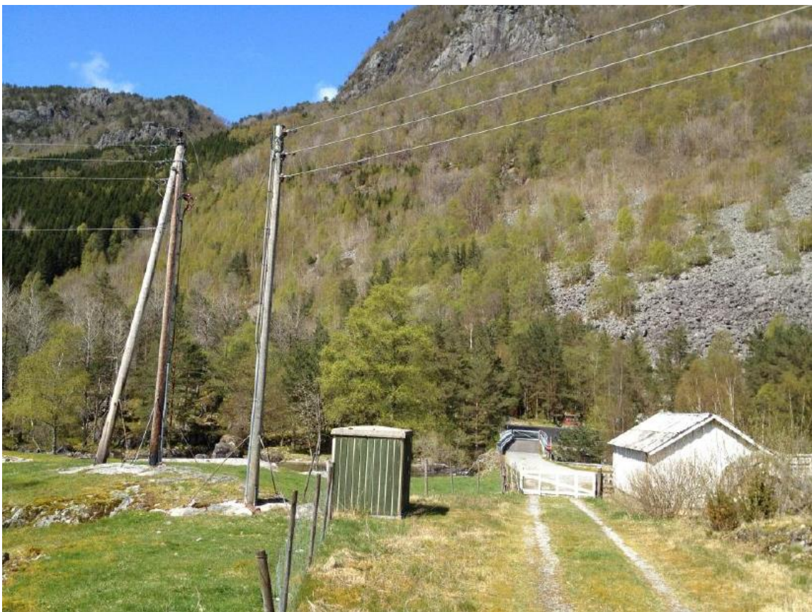
Figur 8 - 22 kV endemast på Nes og adkomstvei
