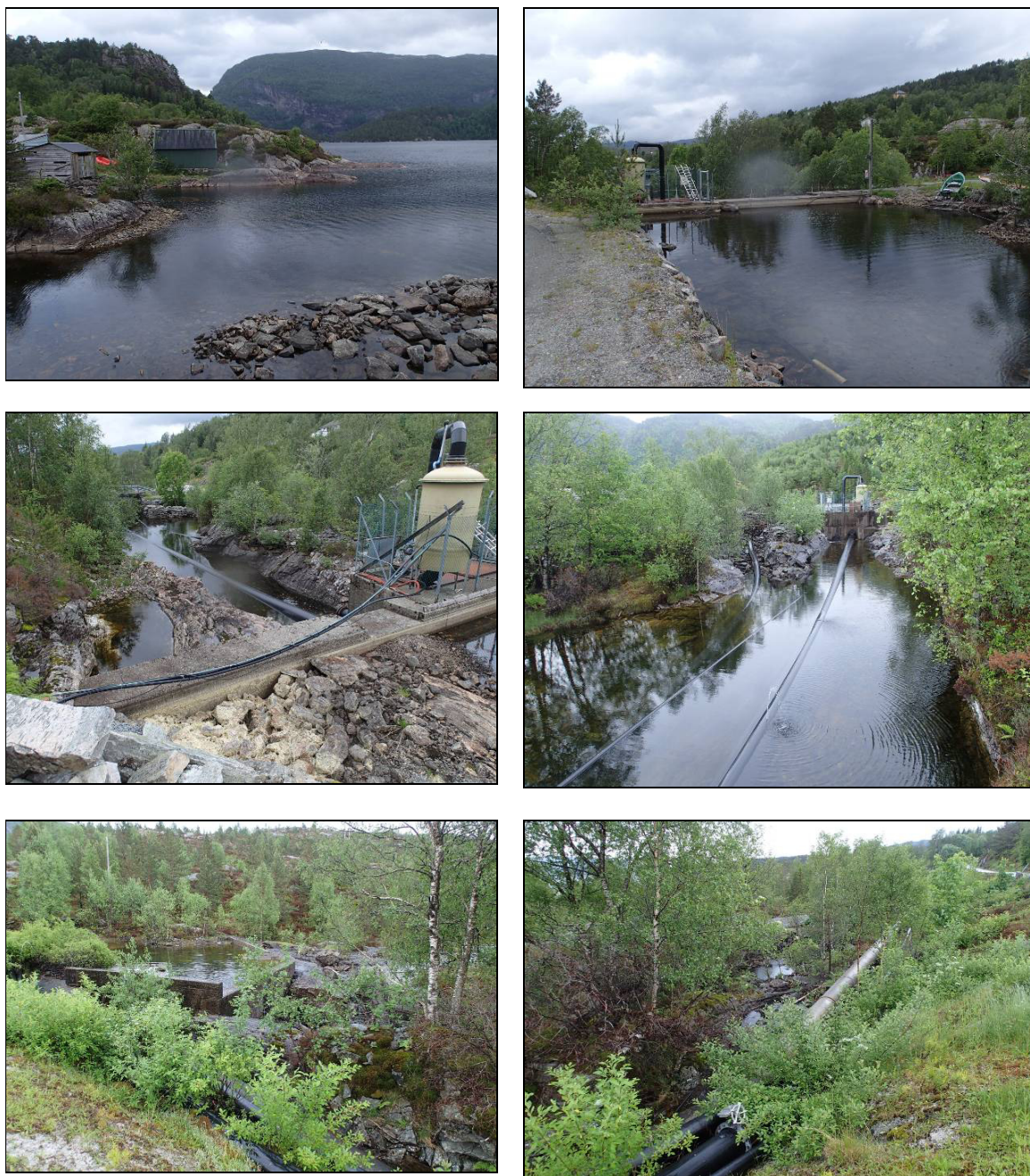
Figur 3. Inntaksstedet for ferskvann er Sørkvingevatnet ( øverst til venstre ) der det er etablert en dam ved utløpet ( øverst til høyre ). Tre inntaksledninger sørger for vannforsyningen til anlegget, og disse går gjennom dammen via elveutløpet ( midten til venstre og høyre ) og videre under veien før de ledes på oppsiden av elveløpet og videre nedover til anlegget ( nede til venstre og høyre ), jf. figur 2 .
