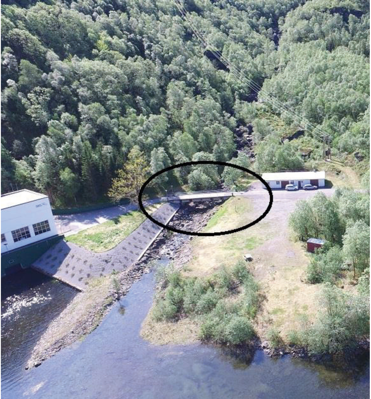
Figur 2-9 Bru ved Hardeland kraftstasjon må oppgraderast for tungtransport
