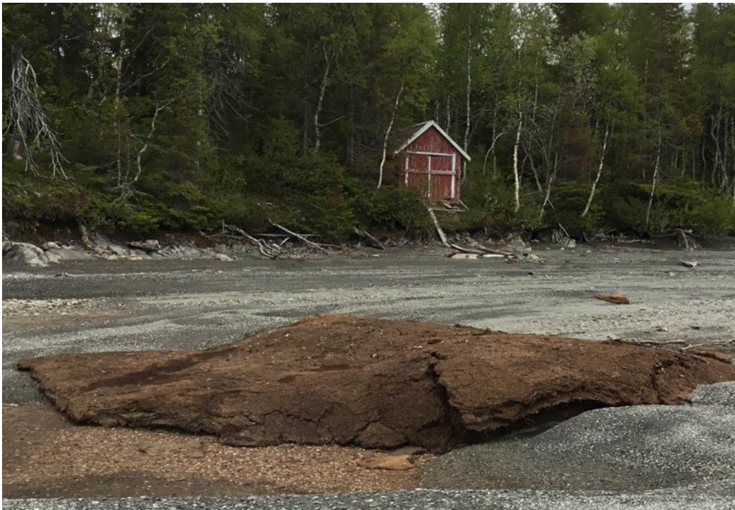
Figur 2-30 Naust som står i fare for å ta skade om erosjon vedvarer, ved Bustadmo.
