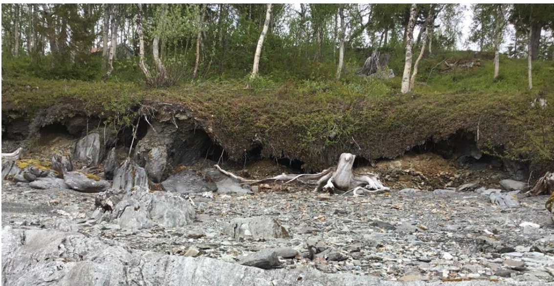
Figur 2-29 Vegetasjonen har fått vasket ut underliggende masse.
