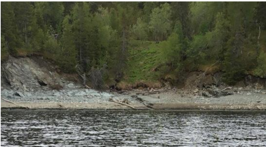
Figur 2-6 Ved Hansvika er det en fylling for å hindre at veien raser ut. Tydelig erosjon.
