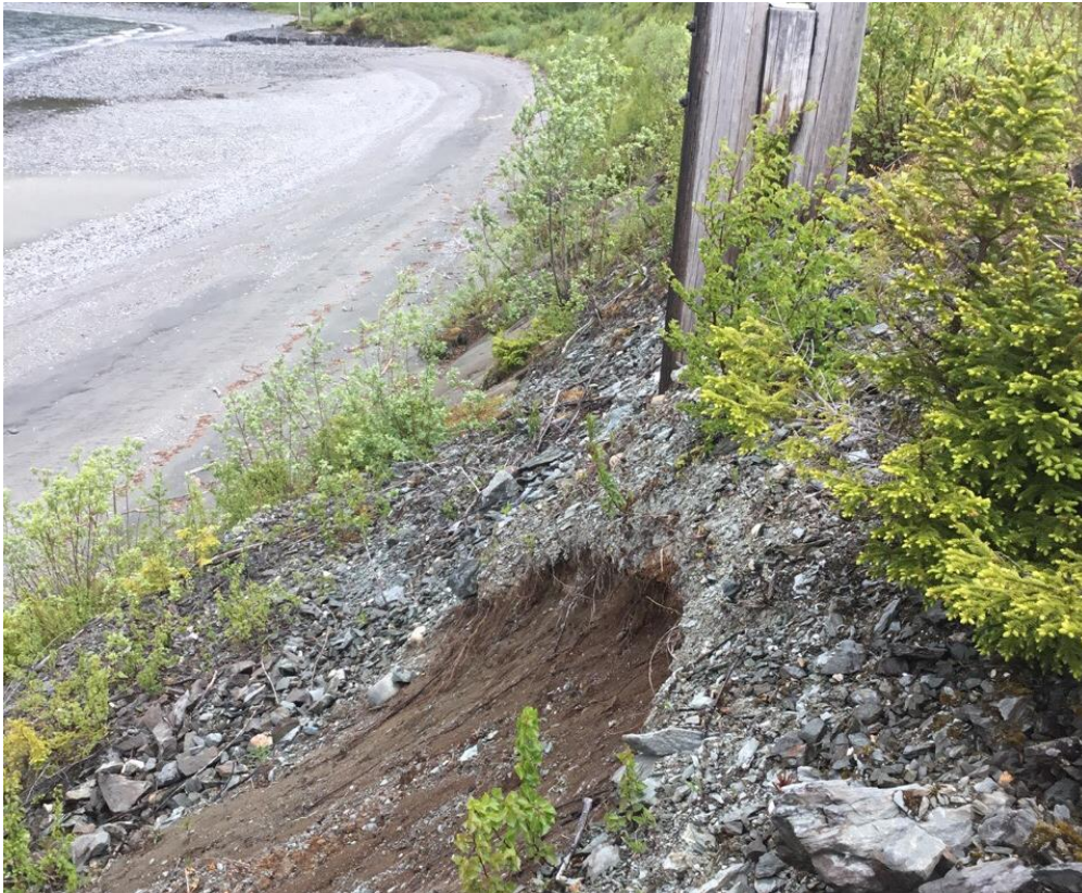
Figur 2-45 Kraftstolpe som står i bratt skråning som eroderer.
