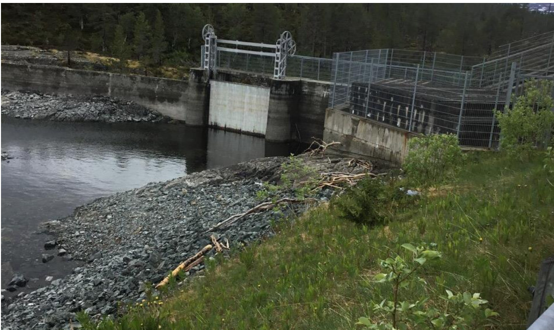
Figur 2-37 Noe nyere trevirke vest for dam. Kan med fordel fjernes.
