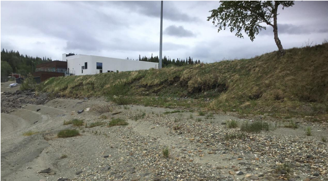
Figur 2-20 Jordvoll som har erodert mot kunstgressbanen.
