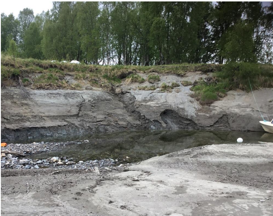
Figur 2-4 Erosjon ved Fjellvang. Traktorvei går langs raskanten, og ligger ca. 1 meter fra kanten. Erosjonen er under noe utvikling. Foto: OKB.
