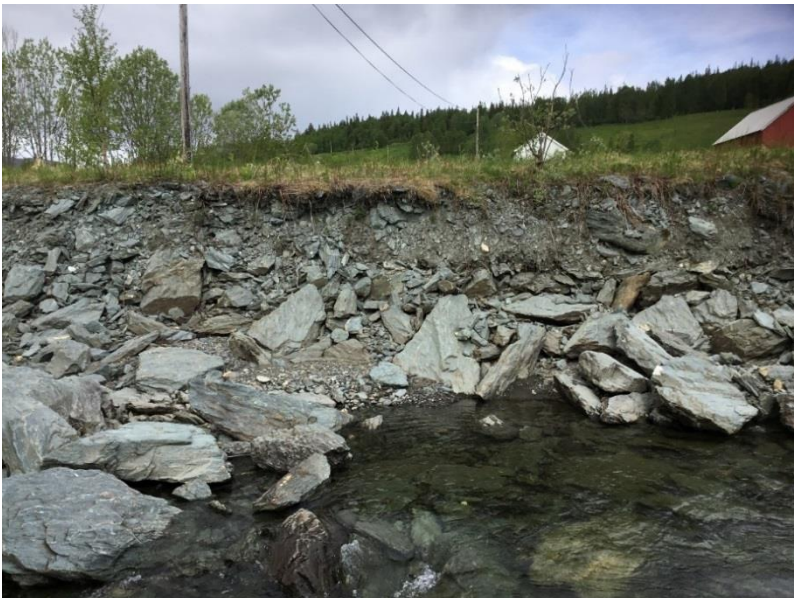
Figur 2-9 Viser sikring som har glidd ut på vestsiden av utløpet.
