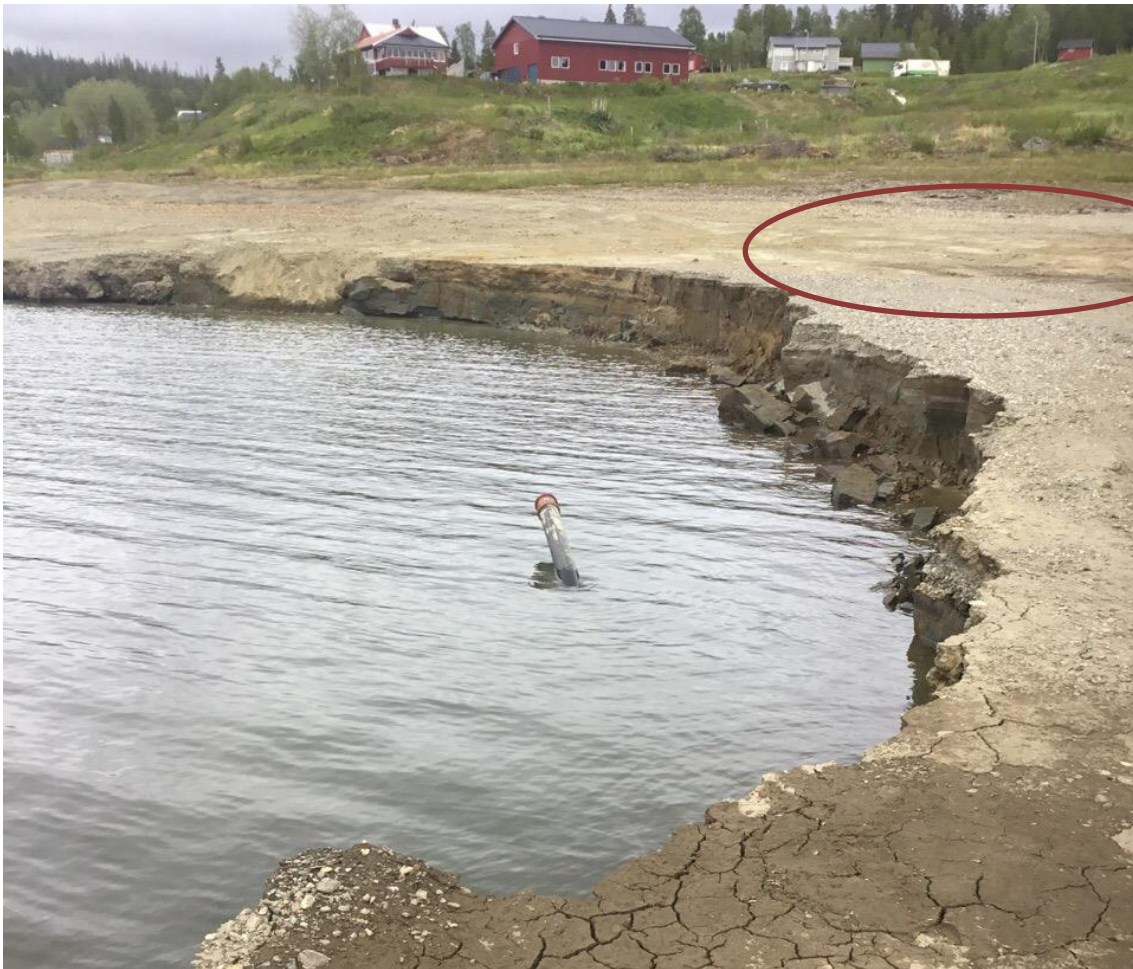
Figur 2-19 Frakoblet avløpsrør som går ut i Limingen. Nytt rør er nedgravd, se rød ellipse. Kalvinger som kan sees på bildet raste ut under befaringen.
