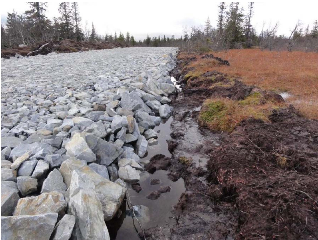
Figur 7: Eksempel på grov veifylling i myrområde fra Blaiken vindkraftverk i Storuman. Foto fra Rambølls kontrollprogram hydrologi for BlaiknVind AB
