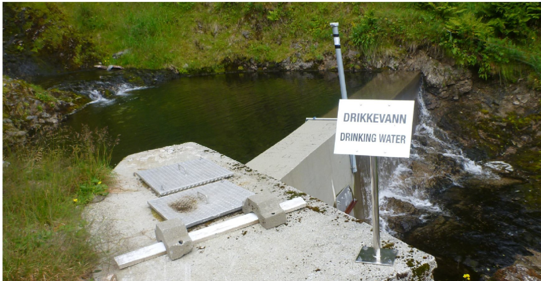
Figur 19: Fra inntaket til Laupstad Vannverk AS på ca. kote 50.
