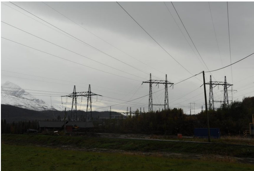
Figur 5-10. Bardufoss transformatorstasjon, sett fra nord.
