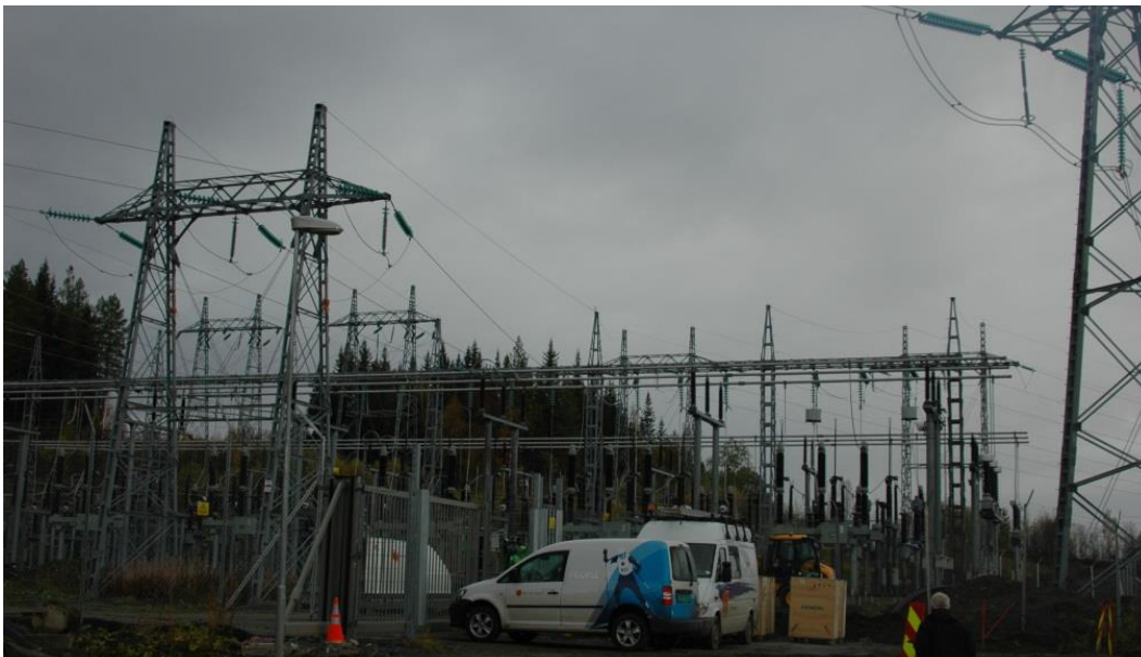
Figur 5-9 Bardufoss transformatorstasjon. Foto Norconsult 2014.
