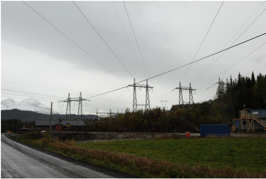
Figur 5-10. Ledninger ved Bardufoss transformatorstasjon, sett fra nord.
