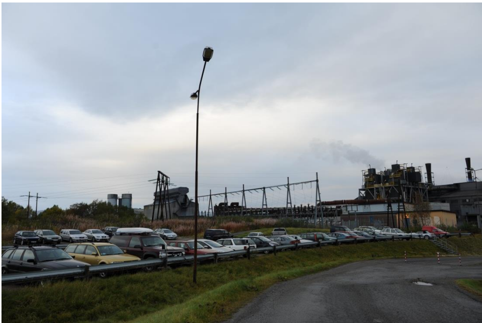
Figur 5-11. Finnfjordbotn transformatorstasjon, med smelteverket i bakgrunnen.
