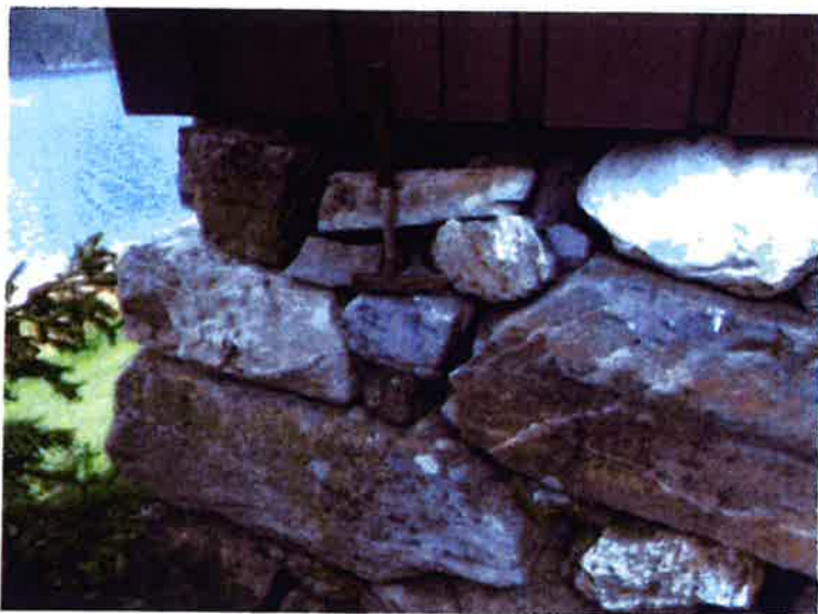
Foto 13. Det SV hjørnet har også løse steiner oppunder bunnsvillen. Foto 10.08.2014.
