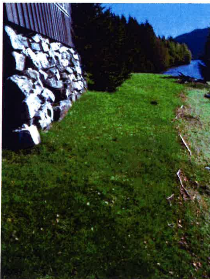
Foto 2. Spor etter høy vannstand og bølgeslag. Foto tatt den 15. september 2011. (Legg merke til at det ikke er falt ut steiner fra grunnmuren på dette tidspunktet.)
