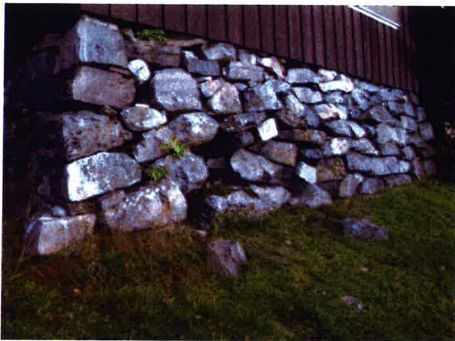
Foto 9. Foto tatt den 29.10.2013. Nå er det falt ut flere steiner av muren.
