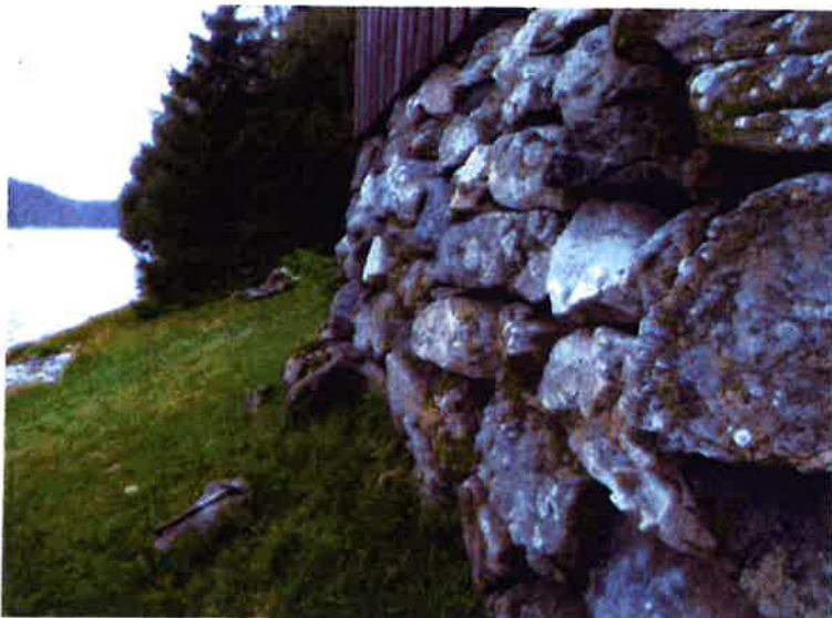
Foto 11. Muren «buler» nå ut på midten, flere steiner har falt ut. Foto 10.8.2014.
