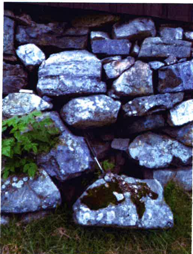
Foto 12. Denne såleblokka ligger nå uten kontakt med resten av muren. Oppunder bunnsvillen er det nå blitt hulrom og løse steiner. Foto 10.08.2014.
