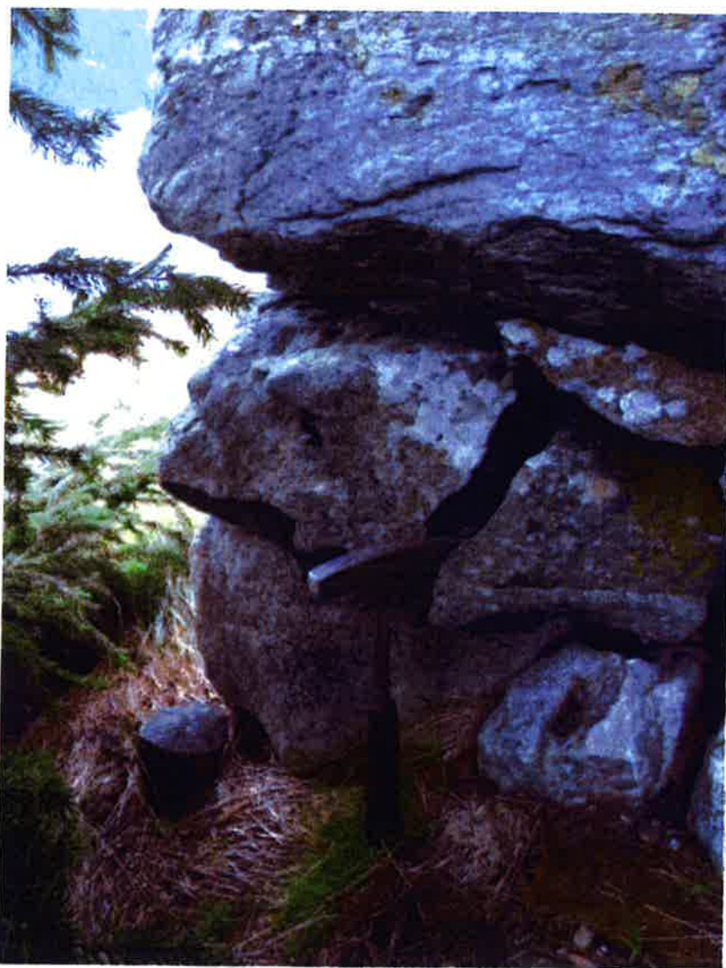
Foto 14. Steinblokk har sprukket og delt seg i to på grunn av belastningen som følge av at steinmuren er i bevegelse. (sprekken ses nederst på foto 13.) Foto 10.08.2014.
