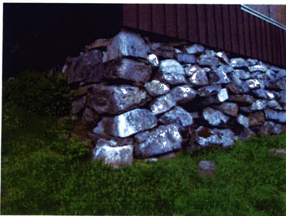
Foto 10. Foto tatt den 6.6.2014. Det er oppstått flere hull og forskyvninger av steinene.
