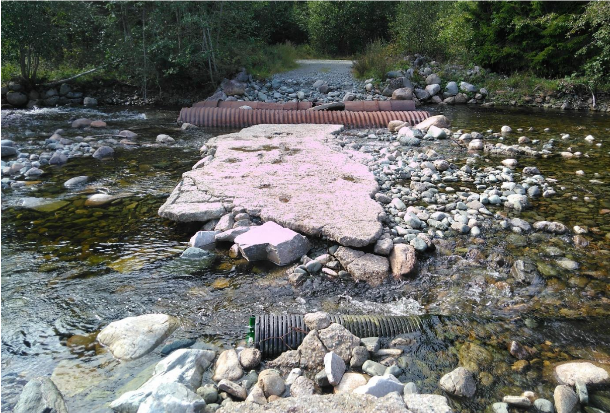
Bilde 2: Betongbru ved Mogen. I dårlig stand, dermed ikke vandringshinder.
