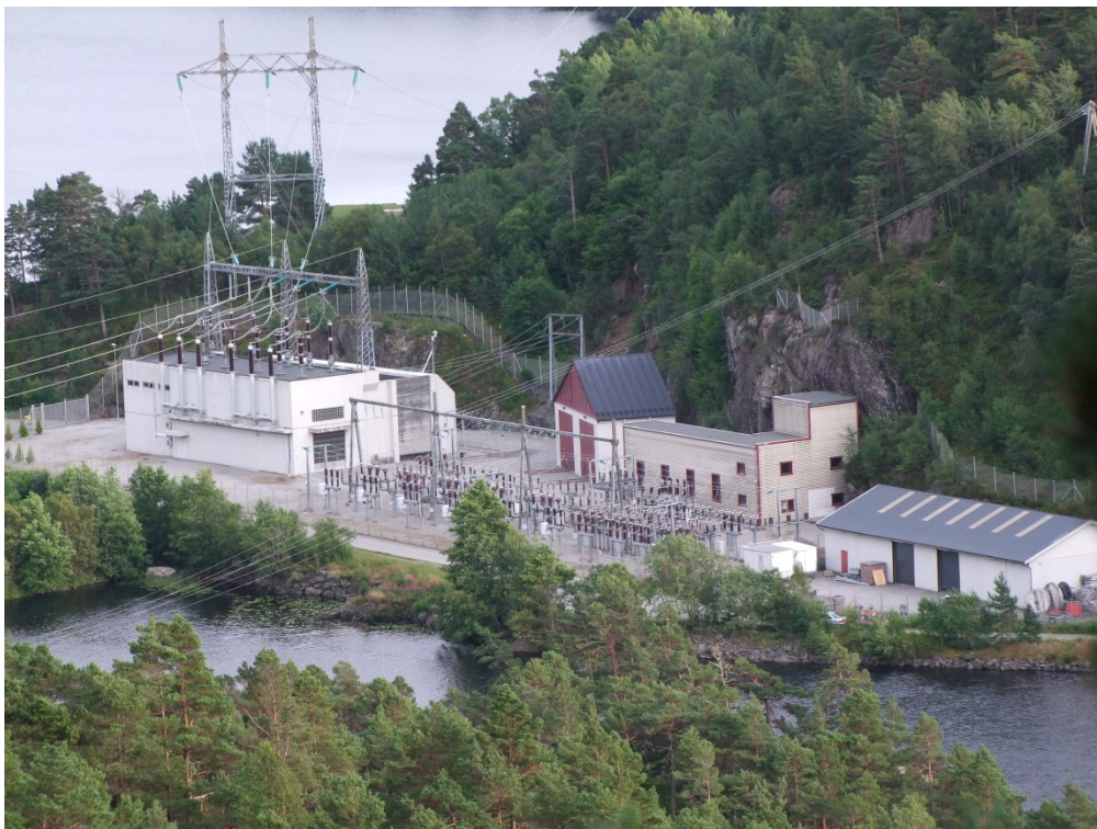
Trafostasjonen til SKL på fyllmassar ved Storavatnet, foto Øystein Kyvik
