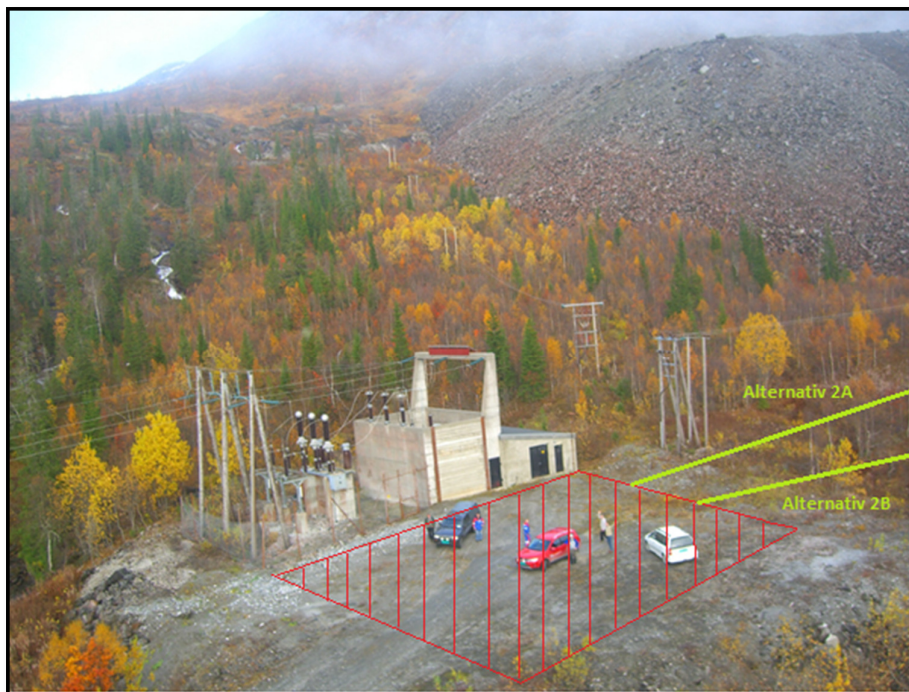
Figur 2-7: Ørtfjell transformatorstasjon (Foto Helgelandskraft)
