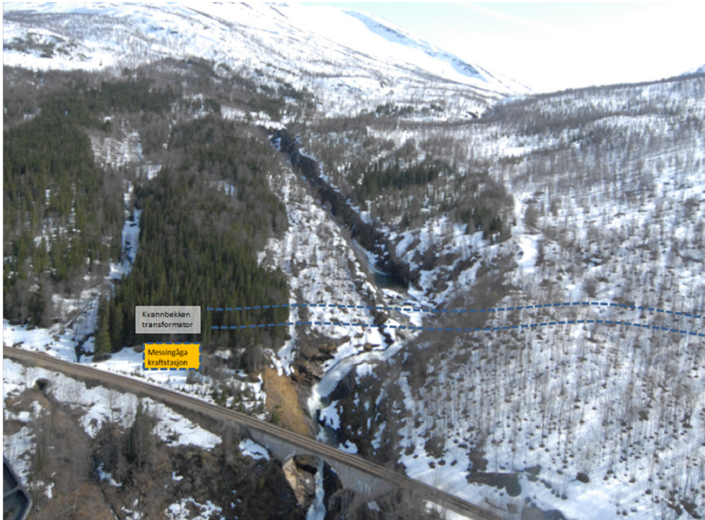
Figur 2-3 Plassering av Kvannbekken transformatorstasjon (Foto: H.Kaasa)
