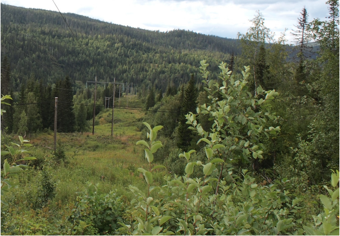
Figur 2-6 Eksisterende 132 kV ledning i Dunderlandsdalen fra Svabo til Storforshei.
