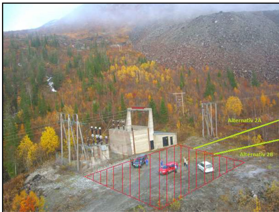
Figur 3-18: Ørtfjell transformatorstasjon (Foto Helgelandskraft)
