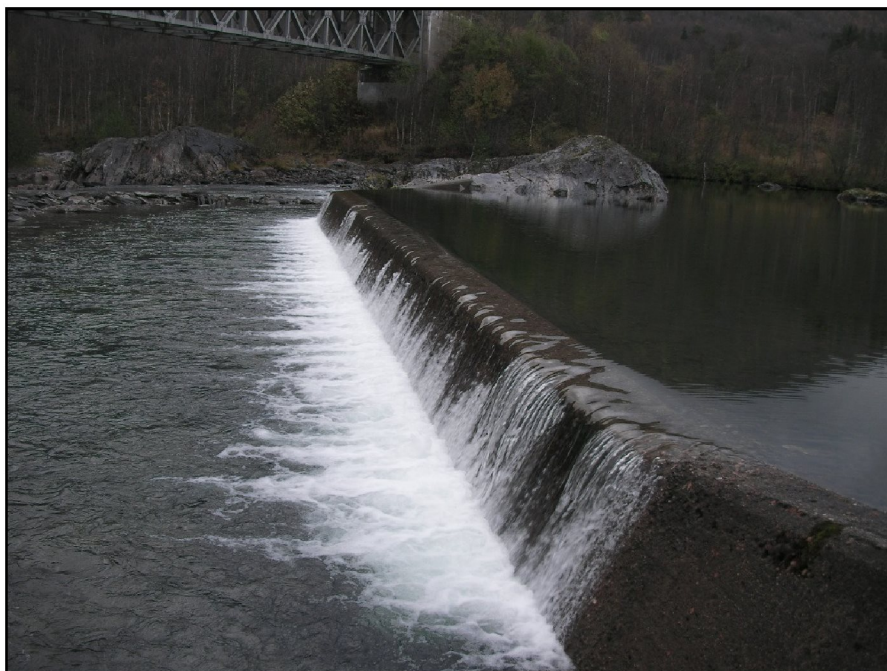
Figur 2 Betongterskel i Ranaelva kote 245.
