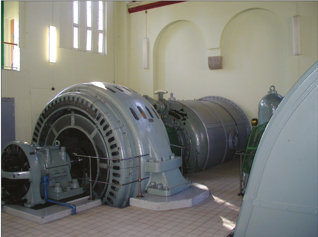
Figur 2.8 Maskineri i gamle Dalsfos kraftverk
