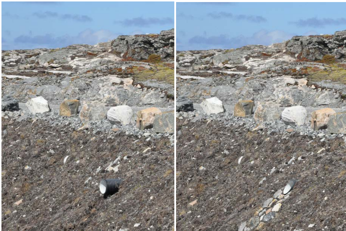
Figur 20. Der stikkrennene ender ut i en skråning er det viktig å plastre i nedkant for å hindre uønsket erosjon over tid.
