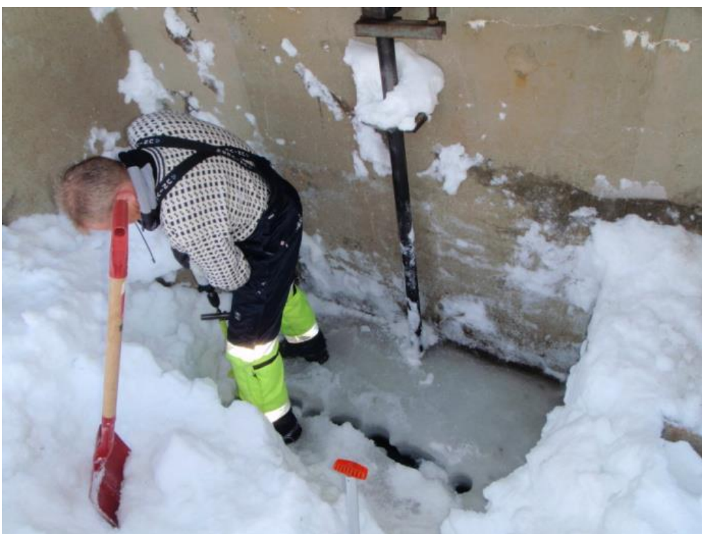
Figur 4. Åpning for slipp av sommerminstevannføring ved inntak Ya 30. april 2010
