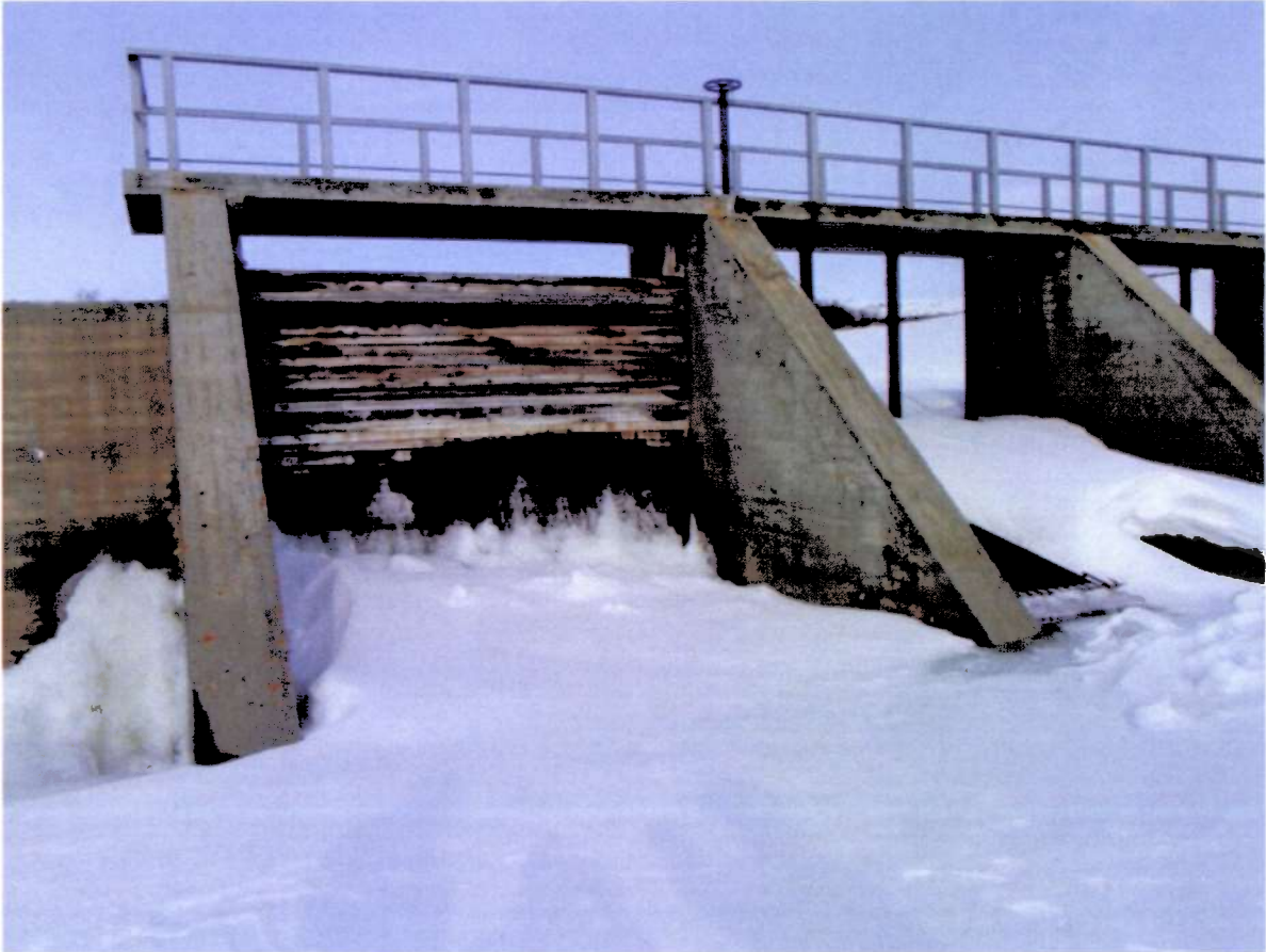
Figur 15 Inntak øvre Dølvad, 21. april 2010
