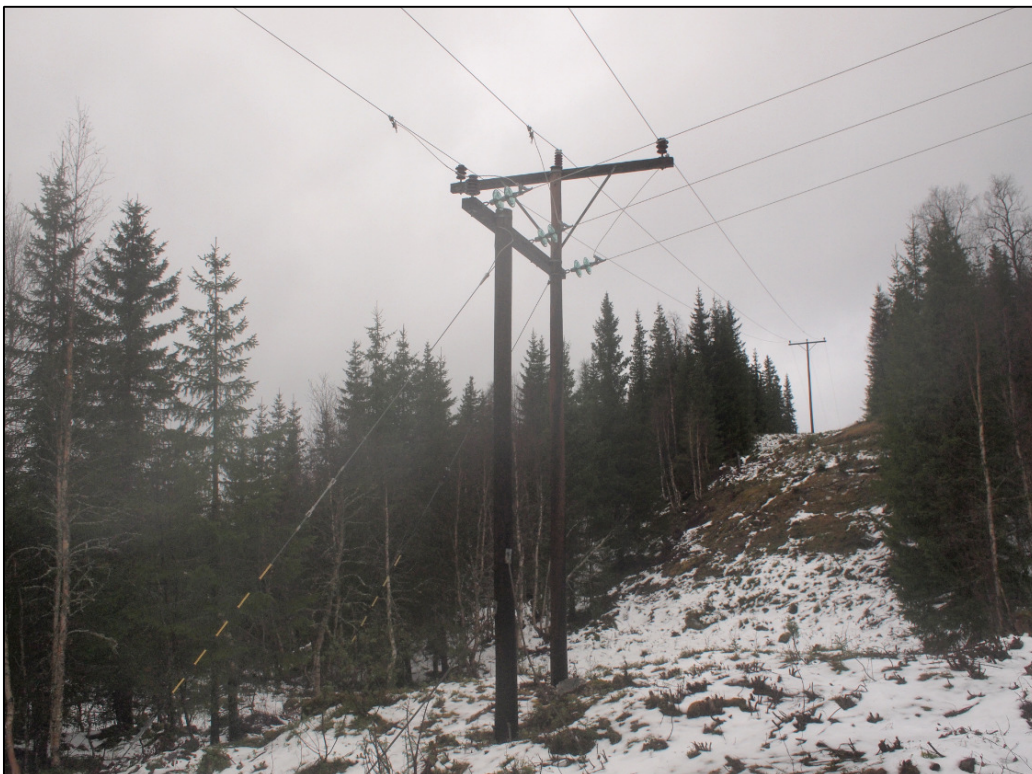
Figur 3-31. Eksisterende 22 kV distribusjonsnett i Kvanndalen, mulig tilkøpling for Silåga kraftverk. Foto: Lars Johansen.
