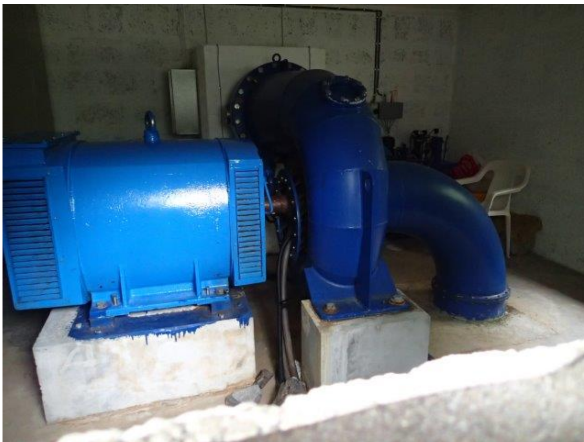
Figur 5: Turbin og generator i eksisterende stasjon.
