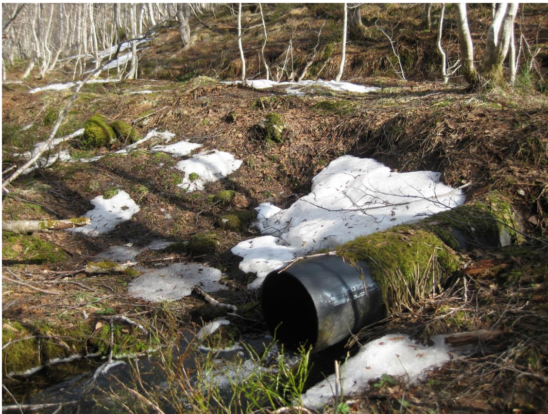
Figur 7. Øverste stikkrenne, ca. 20 meter fra veiens ende ved elva.
