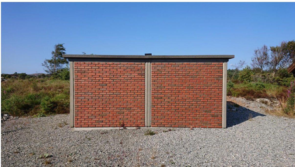
Bilde 1: Eksisterende nettstasjon i Haugaland Næringspark; vindparkens tilknytningspunkt (TP)
