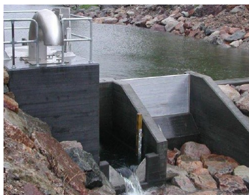
Figur 4: Dam med V-overløp. Vannføringen kan leses av på målestaven (bilde tatt fra NVE-veileder 1/2012)
