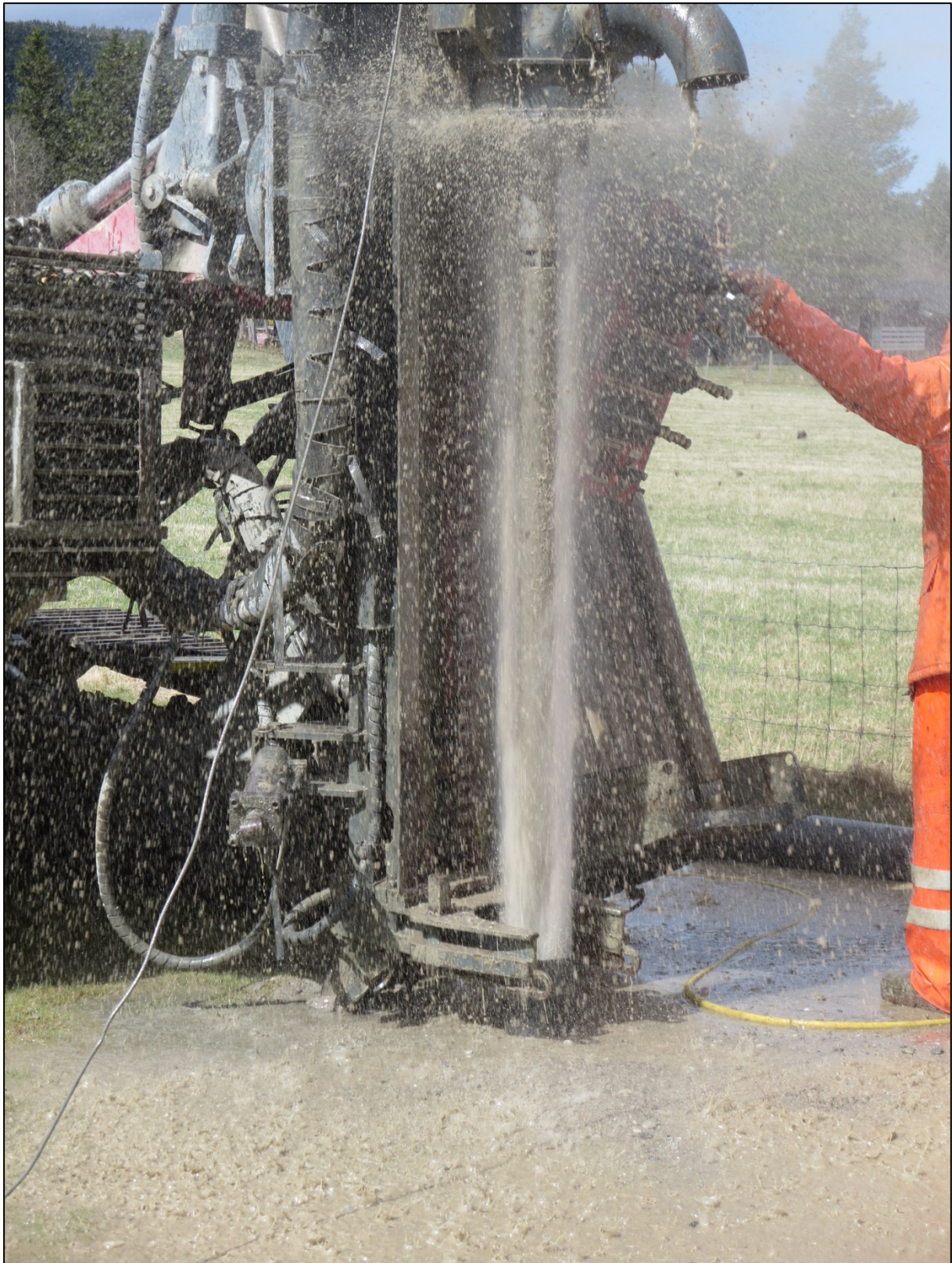
Figur 8. Undersøkelsesboring-1 (Ub-1). Mye vann ved boring mellom 21 og 39 meters dyp.
