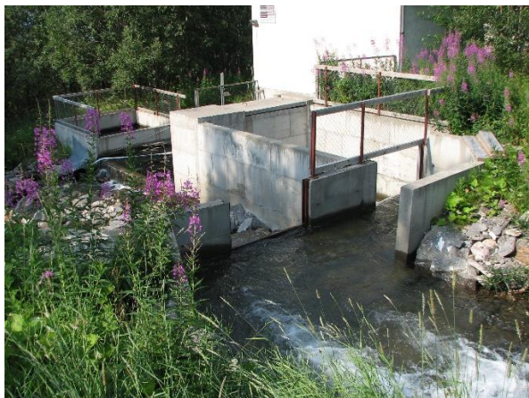
Figur 22. Etablert reservevanninntak til smoltanlegg ved kraftstasjonen
