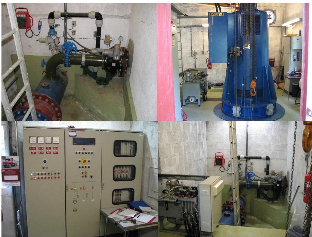
Figur 19. Reservevannvanninntak til smoltanlegg, turbin og styringstavle på kraftstasjon
