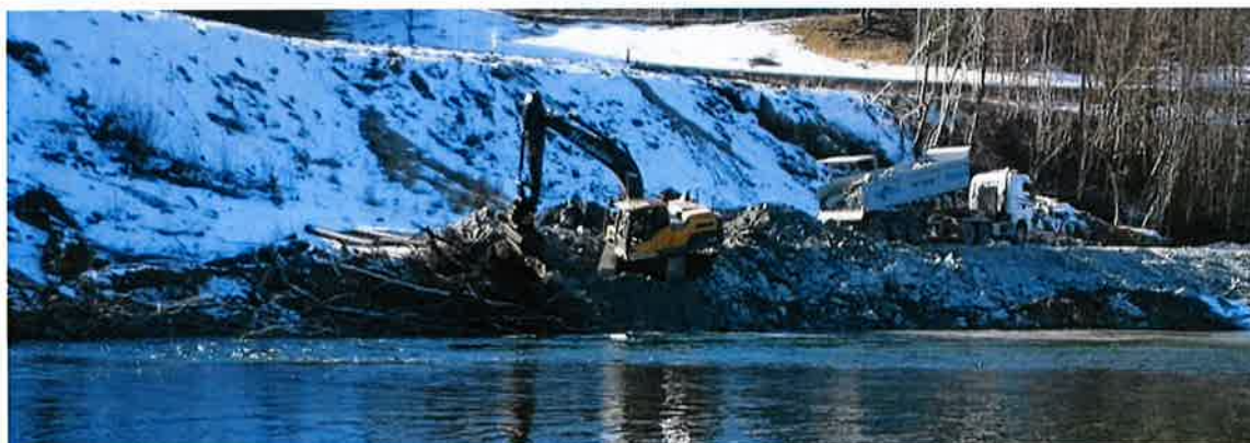
Fig. 18 Utlegging av samfengt sprengstein for anleggsveg og erosjonssikring gjennom skredområdet. Foto: Kon-Sul AS 8. mars 2016
