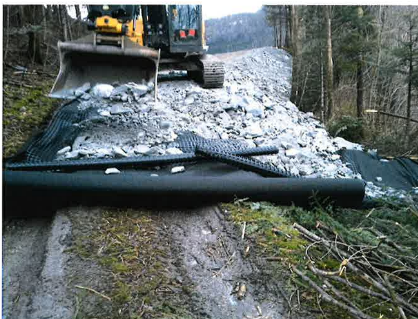
Fig. 16 Utlegging av samfengt sprengstein for permanent anleggsveg. Fiberduk mot grunnen, geotekstil mot fylling. Foto: Kon-Sul AS 24. februar 2016
