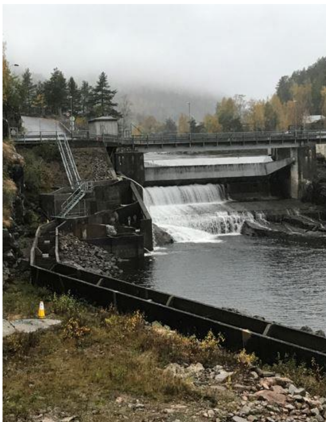
Figur 2-14 Fisketrappa sett mot dam. Attraksjonsvann slippes fra segmentluka mot øvre innhopp.
